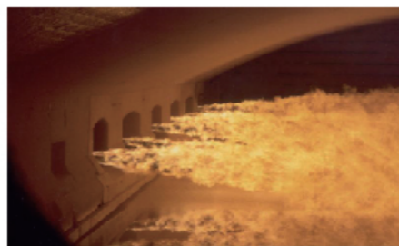
窑炉火焰燃烧监控系统
